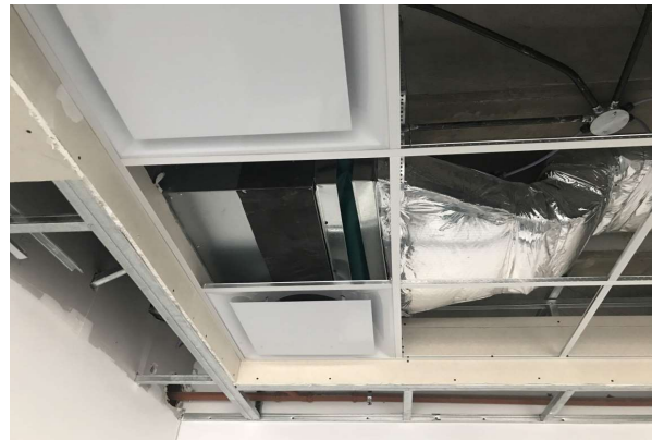
EQUIPOS DE AIRE ACONDICIONADO Y DISFUSORES
