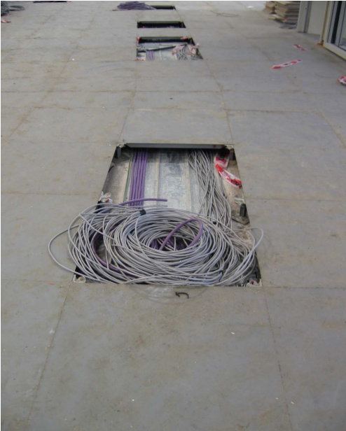
CABLEADO ESTRUCTURADO BAJO PISO TECNICO
