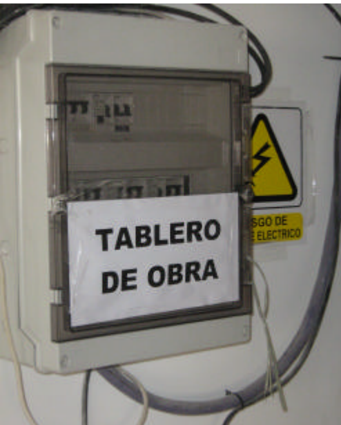
INSTALACIÓN DE TABLERO PROVISORIO PARA ENERGÍA ELÉCTRICA DE OBRA CON PROTECCIÓN REGLAMENTARIA
