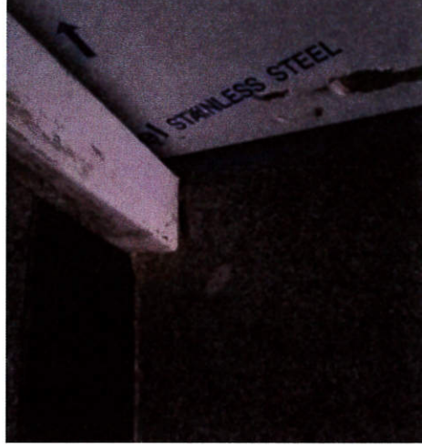
08. Piso picado en esquina con unión de perfil de puerta a ascensor. ✓
