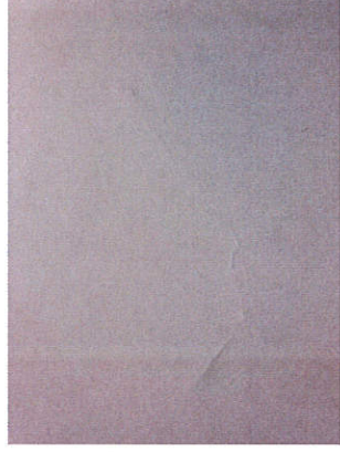
10. Fisura en mampara.
