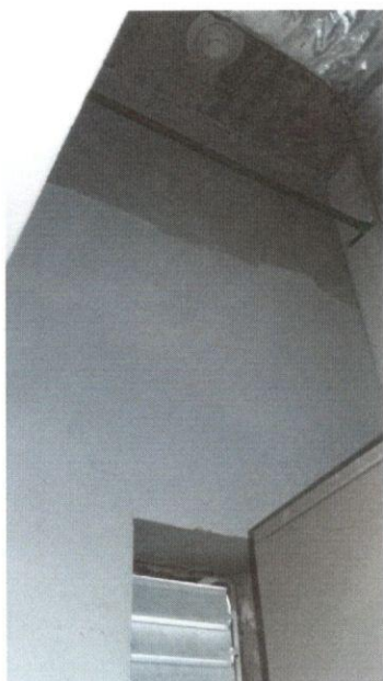
12. Pintura en Sala Tecnica AA
