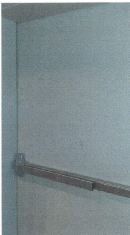
01. PUERTA CORTAFUEGO CON MANCHAS
