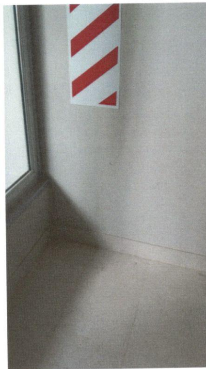
03.MANCHAS EN PAREDES
