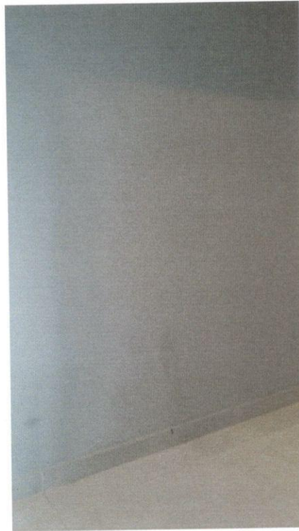
02. MANCHAS EN PAREDES
