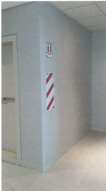
05.SOPORTE SIN EXTINTOR
