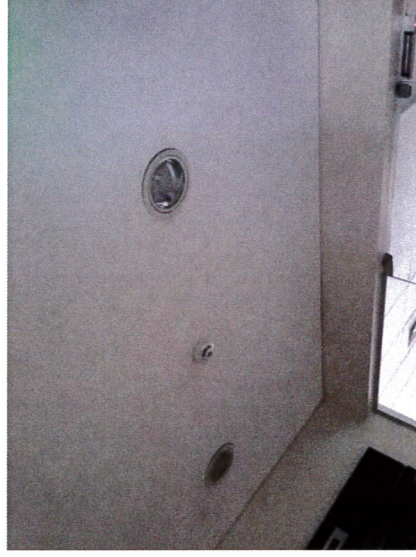
12. Luces del palier sin funcionamiento.
