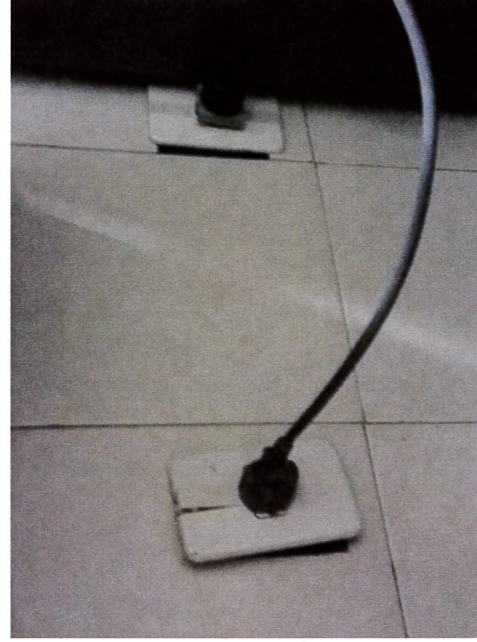
07. Caja de eléctrica desprendida de pared.
