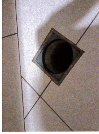
02. Registro de piso sin rejilla tapa.
