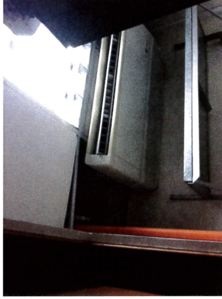
09. Sin un módulo de placa en cielo raso.
