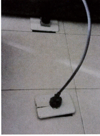
08. Caja de eléctrica desprendida de pared.
