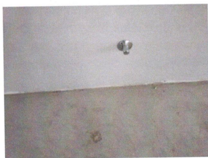
17. Terminación de boca de desagüe tapado con cartón.
