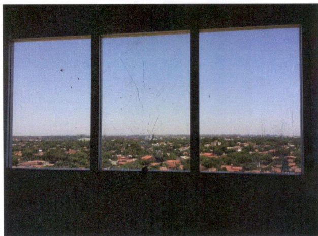
21. Vidrio roto en Hoja móvil de ventana. Restos de mezcla en el exterior.
