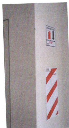
10. Canto de pared picado. Sin extinguidor. ✓
