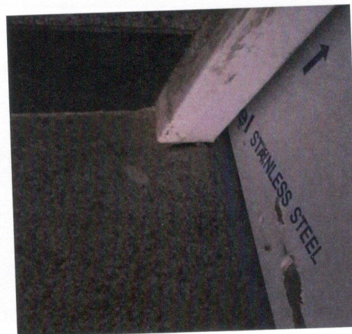
08. Piso picado en esquina con unión de perfil de puerta a ascensor. ✓
