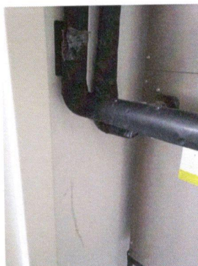
16. Terminación mampostería rota, caja de eléctrica sin tapa.
