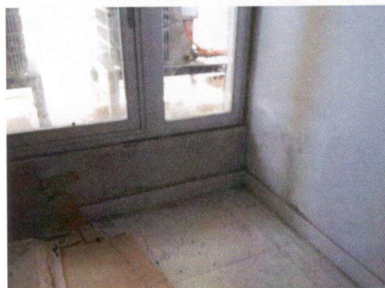
02. Terminación de antepecho de puerta a terraza sin pintura. ✓
