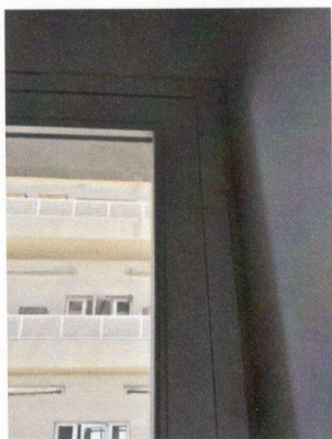
03. Terminación de uniones pared/perfil de apertura. Espuma visible
