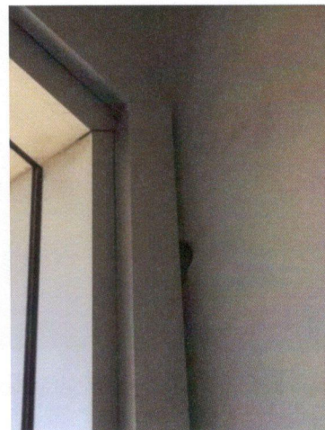
22. Terminación pilar / ventana. Hueco.
