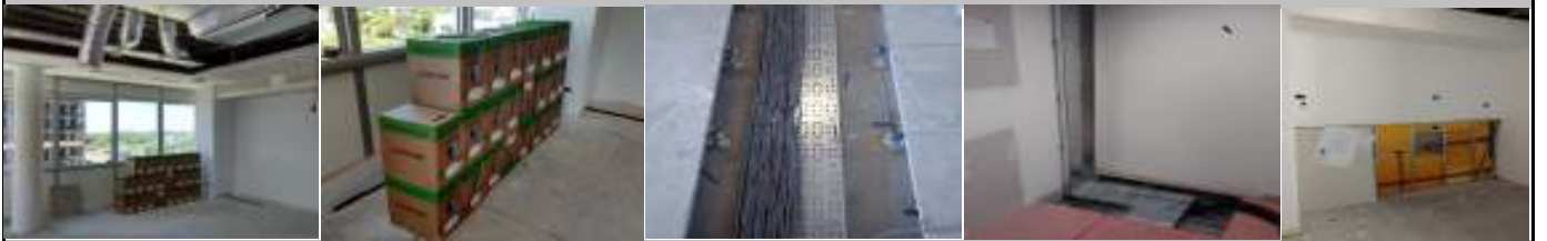
Fotos generales de cableados e Instalación Sanitaria de Tanque de Bombeo
