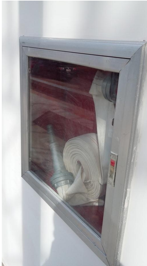
08. BIE con golpes y rayaduras
