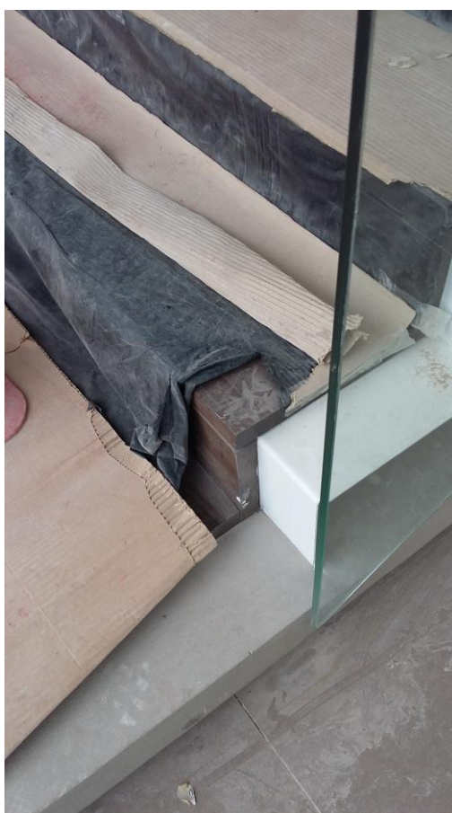
01. Llegada de Escalera con manchas
