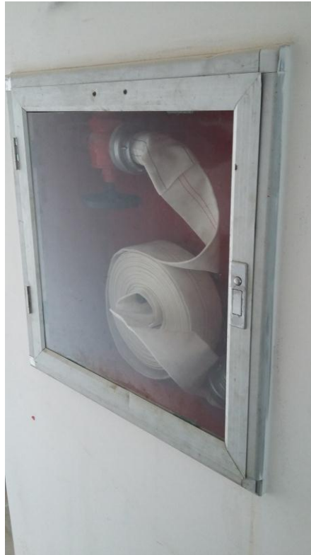
25. BIE con golpes y rayaduras
