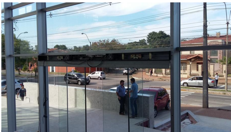
07. Automatizacion de Abertura Principal
