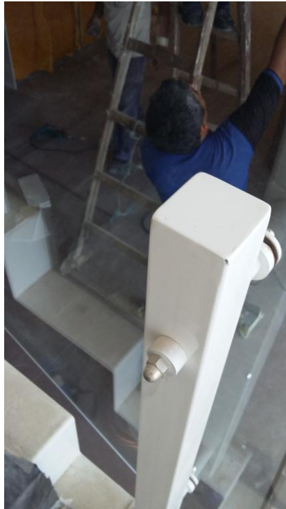
16. Soporte baranda de escalera golpeados y rayones
