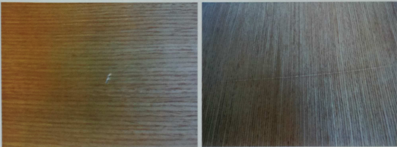
5. Rayón y daños en puerta de madera de unidad 602
