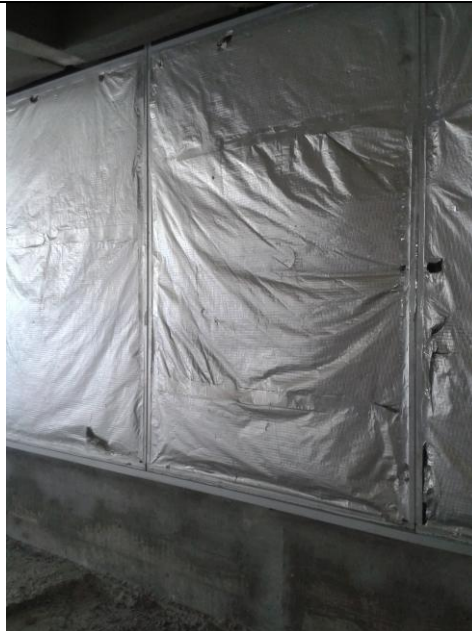
Estado de la Aislación
