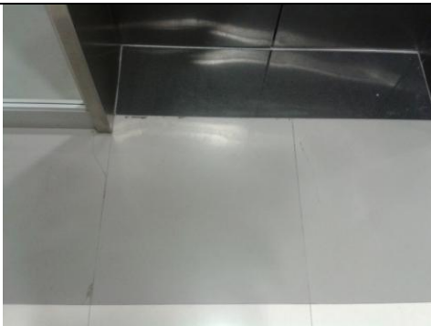
Cerámicas de piso, rotas a la salida del ascensor de servicio.
