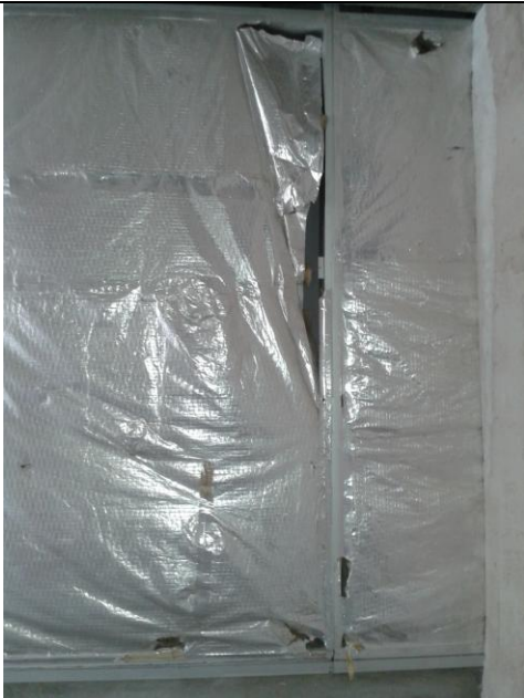
Estado de la Aislación
