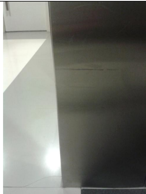
Cerámicas de piso, rotas a la salida del ascensor de servicio y lateral de acero inox. Rayado.
