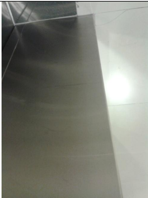
Cerámicas de piso, rotas a la salida del ascensor de servicio.
