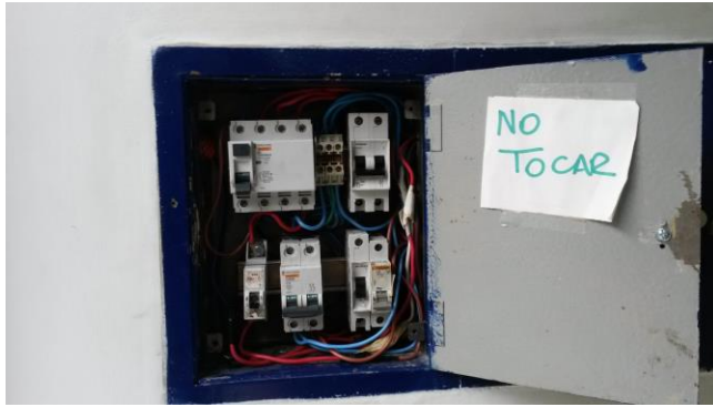
Foto 22 a-b Tableros de iluminación
