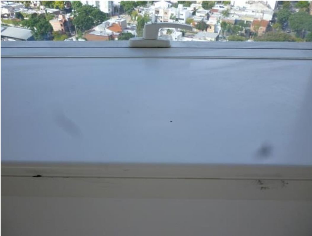
Antepechos con manchas negras.
