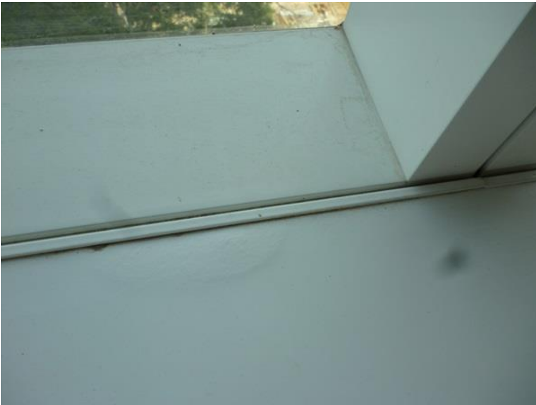
Antepecho estropeado, hinchado.
