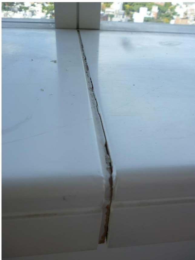
Antepecho suelto y marcado.
