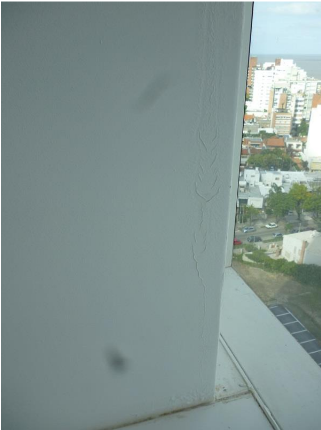
Enduido marcado en pilares fachada sur.
