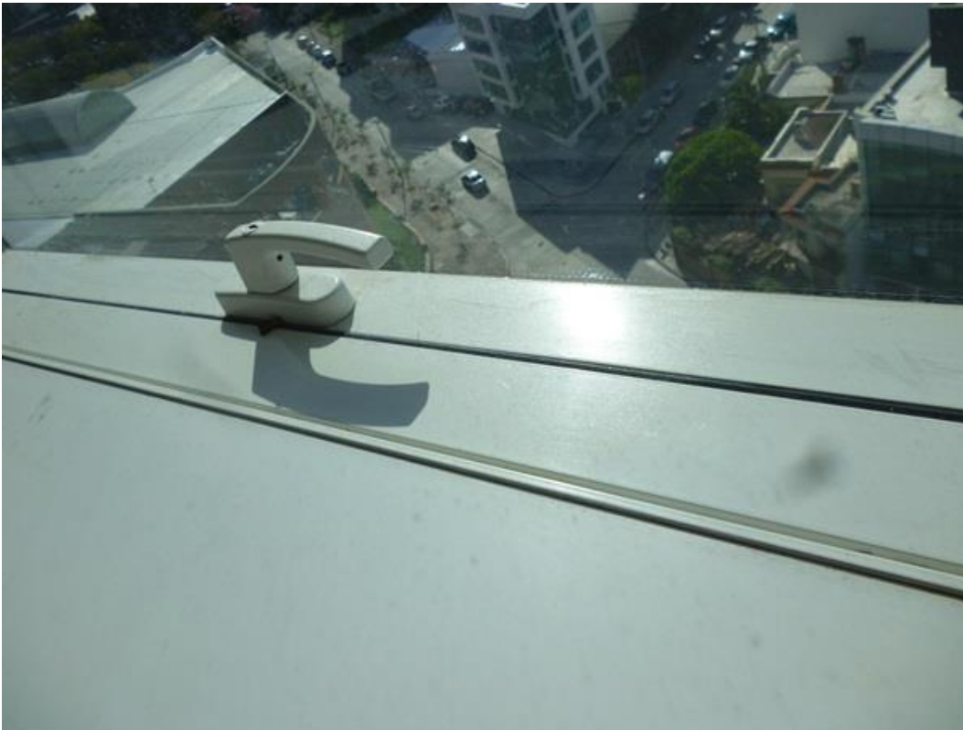
Antepechos con pintura dañada en sector Norte.
