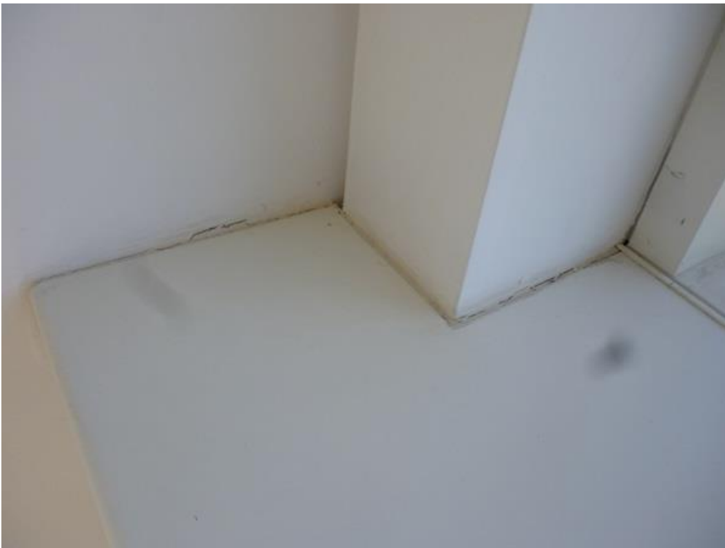
Encuentro antepecho y pilar con fisuras.
