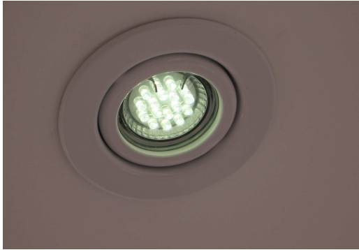
INSTALACION DE ILUMINACION TECNOLOGIA LED.
