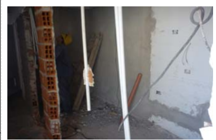
Sala de Cableado 4° según v11-03
