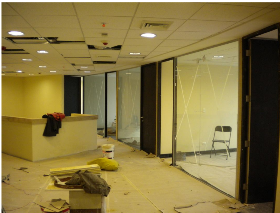
Foto 2_ Mueble asistentes izquierda. Falta lustre madera del mueble. Puertas colocadas, faltan ajustes de amure y sellado contra perfiles aluminio.
