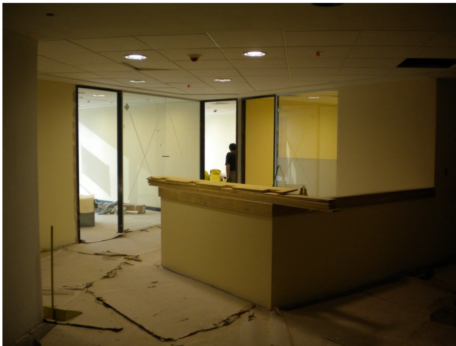
Foto 1_ Mueble asistente acceso. Falta lustre de madera del mueble. Se está colocando film en el vidrio de la oficina detrás.
