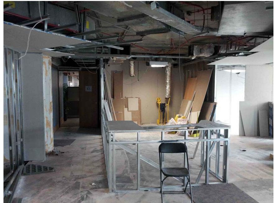
FOTO 2 – VISTA ACCESO LATERAL IZQUIERDO
