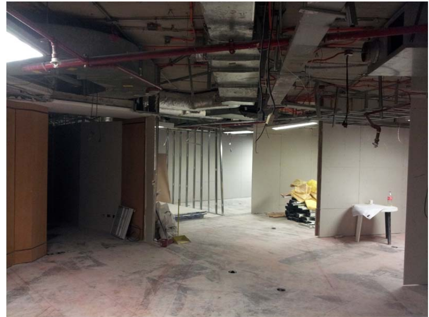
FOTO 2 – VISTA ACCESO LATERAL IZQUIERDO
