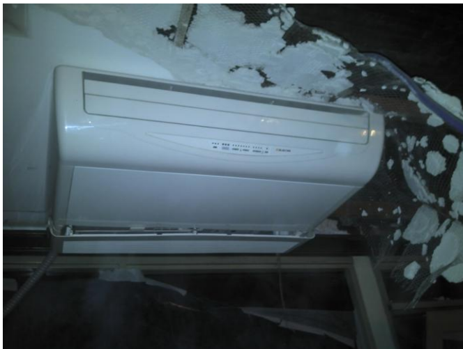
Split de Techo
