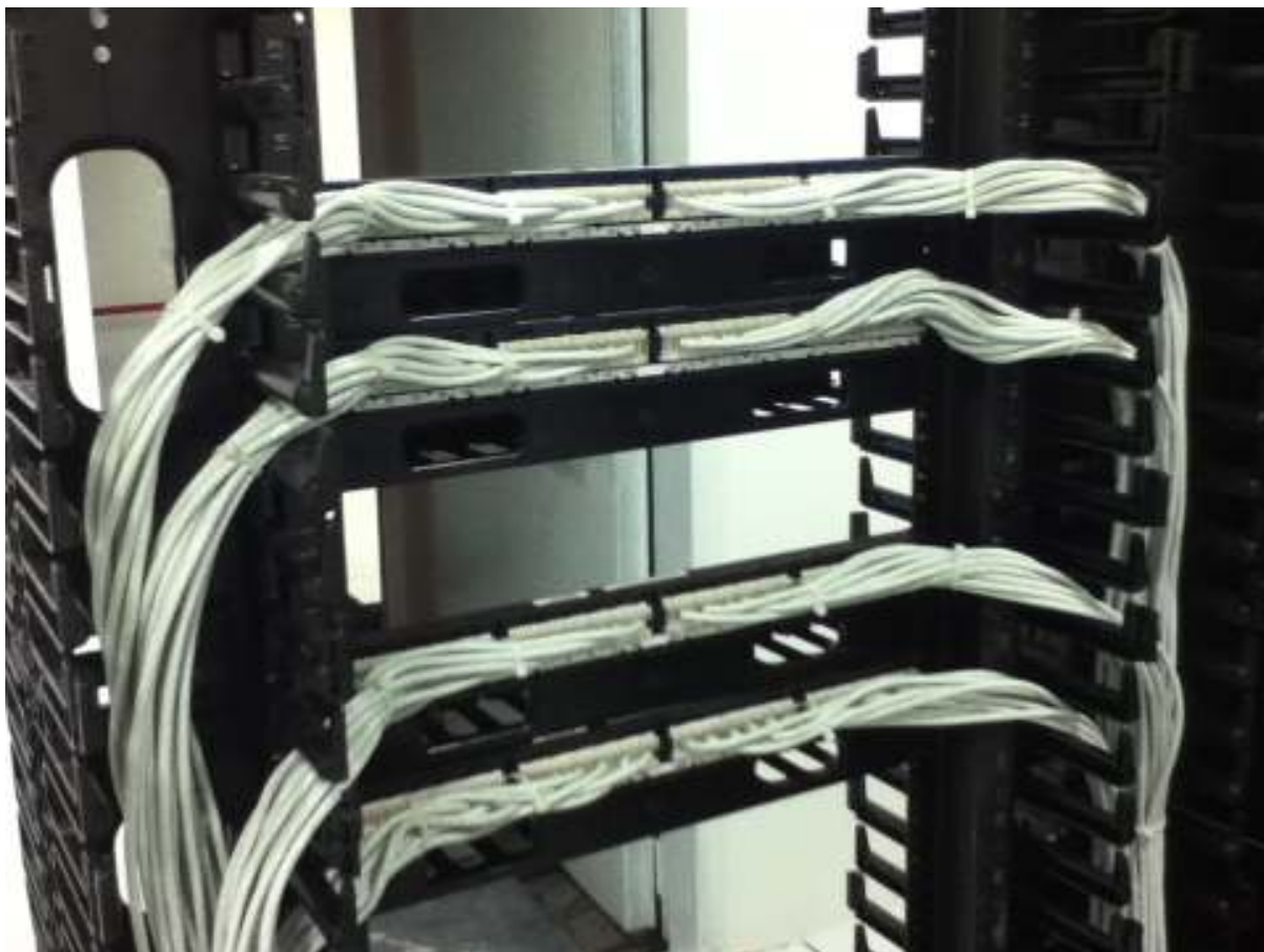
Foto 13 - Datacenter: Detalle de rack abierto con llegada de cableado UTPa patchera.
