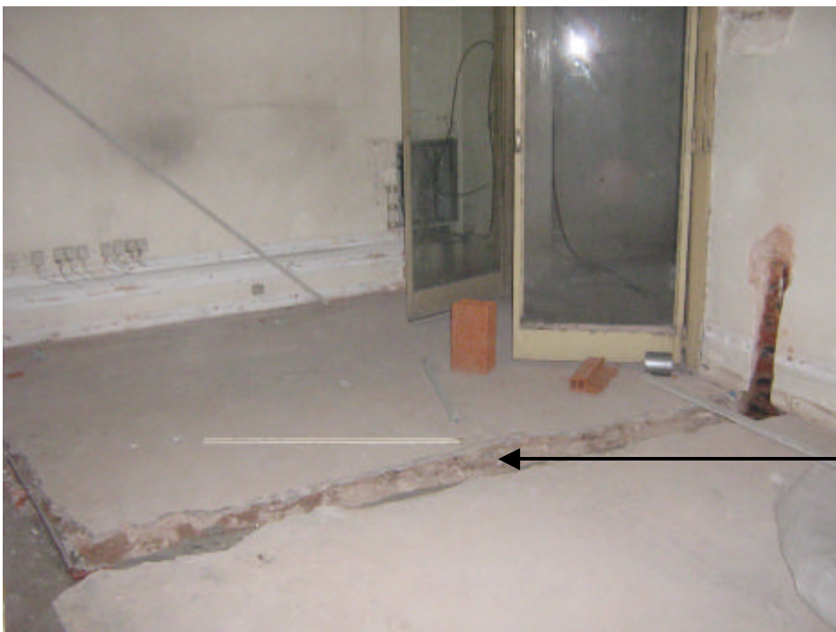
Acometida de agua para Sala Hidroterapia
