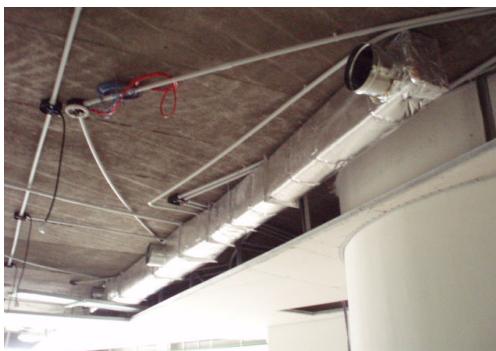
COLGADO CONDUCTOS AA PISO 9.
