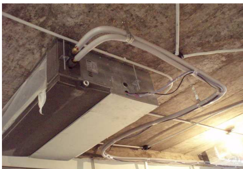
CONEXIÓN EQUIPOS PISOS 03 Y 07
